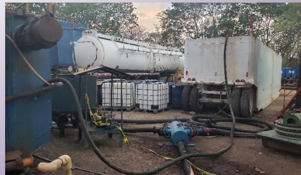
TANQUES CON FLUIDO DE TRABAJO
